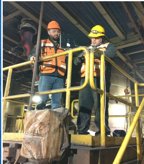
CCTV instalación en Ternium
