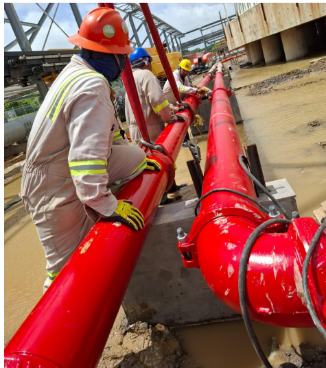
Tubería en Terminal Química puerto México.
